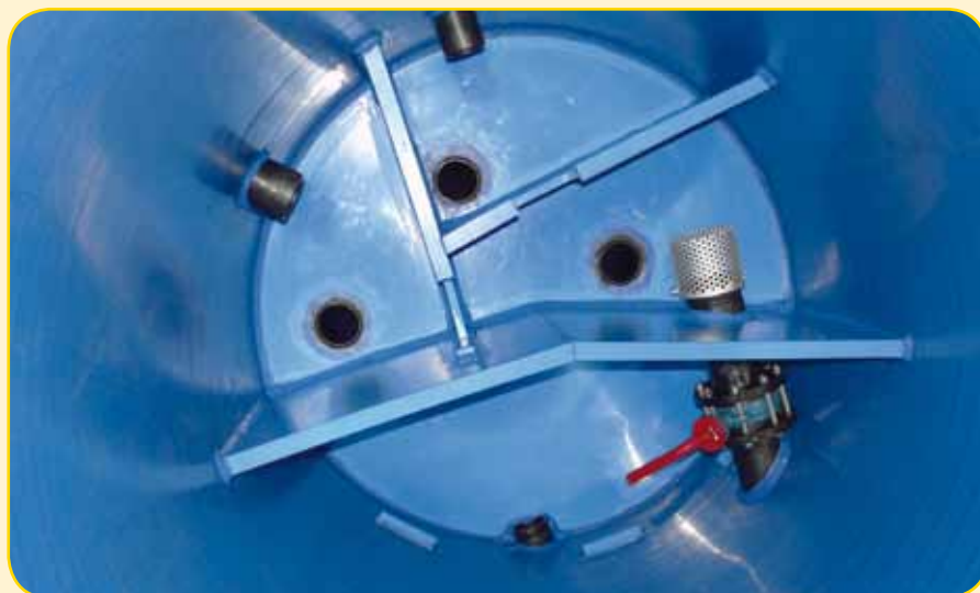
FTW®-Quellsammelschacht DN 1500 mit Zu- und Ablauf inkl. Seiher und Absperrklappe
