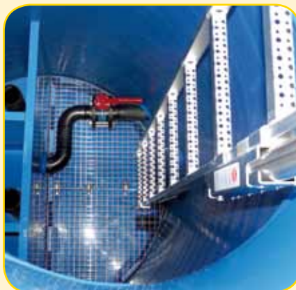
Einstieg über Edelstahlleiter mit ausziehbarer Sicherheitseinstieghilfe über Trockenbereich
