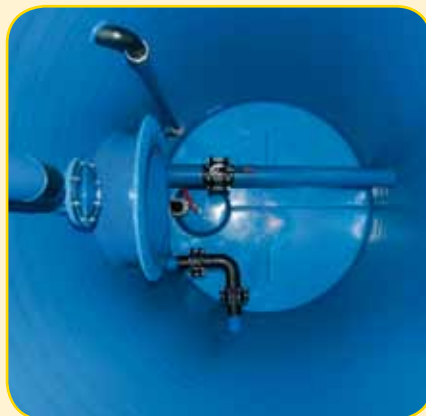
FTW®-Wartungs- und Kontrollschacht am Trinkwasserspeicher
