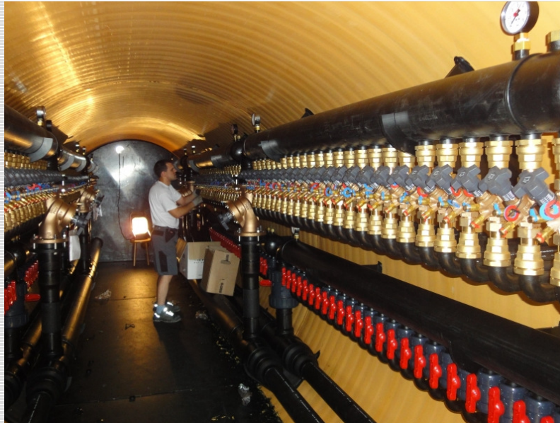
Abb. 5: Werksseitige Vormontage der Verteiler inklusive aller Absperr- und Regelarmaturen
